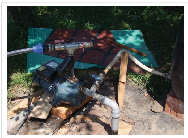
Direktno navodnjavanje iz akumulacionog betonskog tanka.
